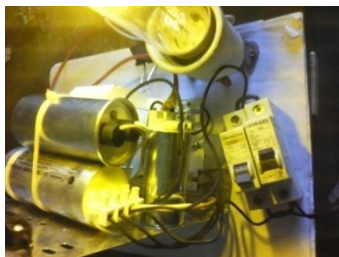
Gambar 4.17. Pengujian ignitor lampu sodium dapat menyala. ( sumber pribadi )
