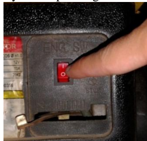
Gambar 4.10 Switch Genset ( Sumber: Pribadi )
